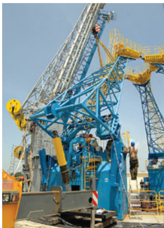
Стартовый комплекс для ракеты Союз - ST во Французской Гвиане – спроектирован и построен при участии инженеров – выпускников МГТУ им. Н.Э. Баумана
